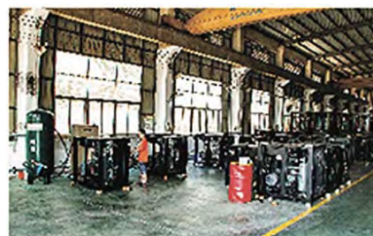
测试车间 TEST WORKSHOP
